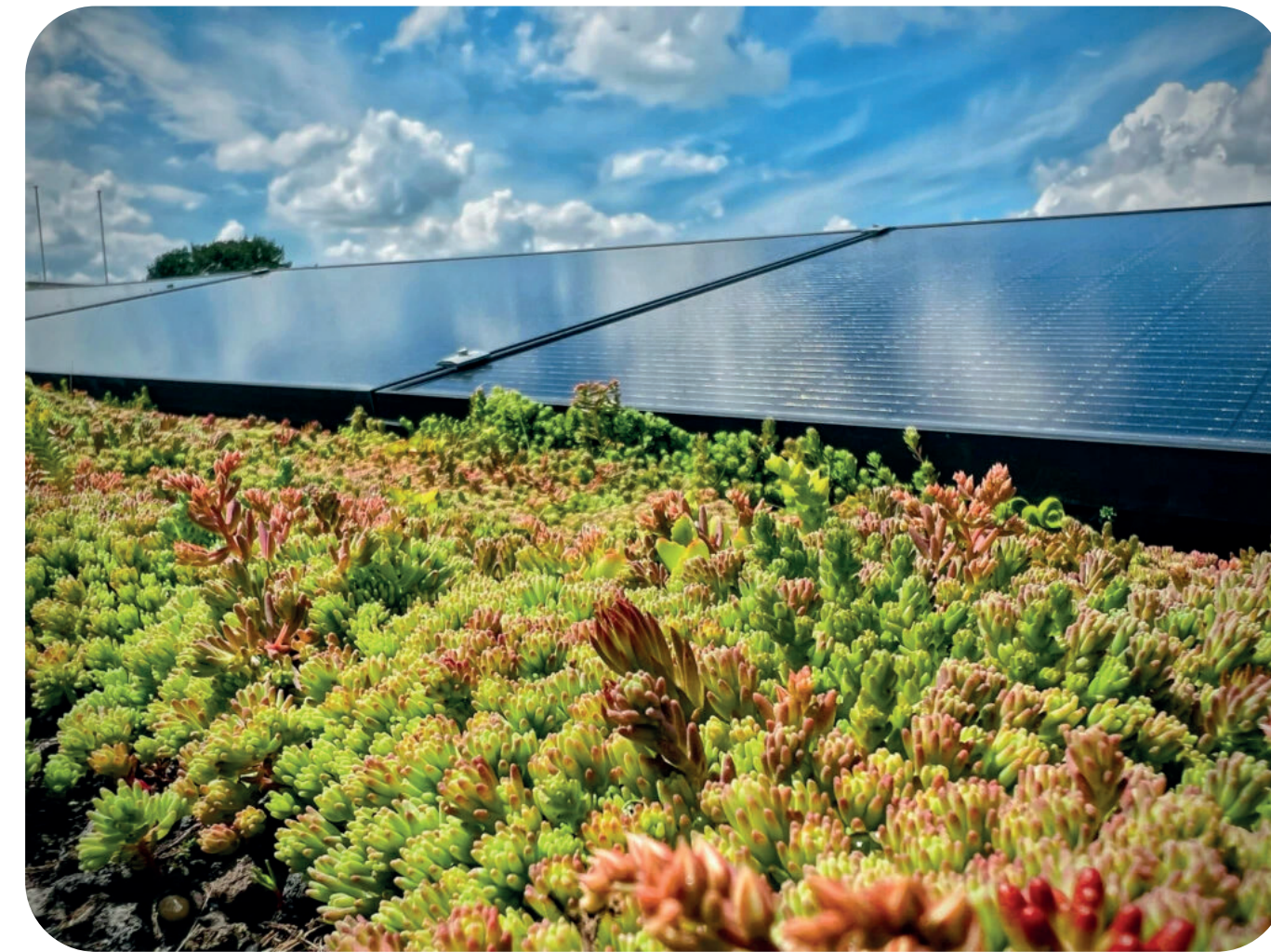
Opwekking via PV-panelen in combinatie met een mos sedumdak
