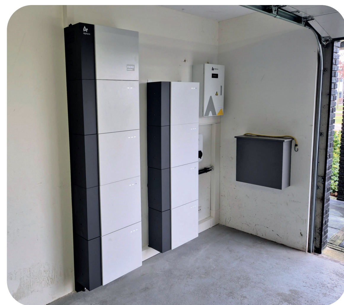
Thuisbatterij in de woning
